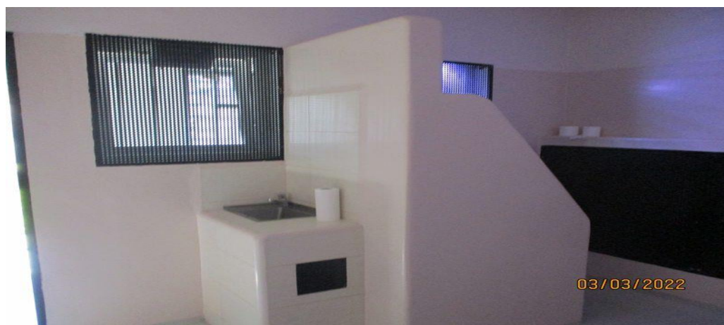
Просторија за задржавање у ПС Ириг
